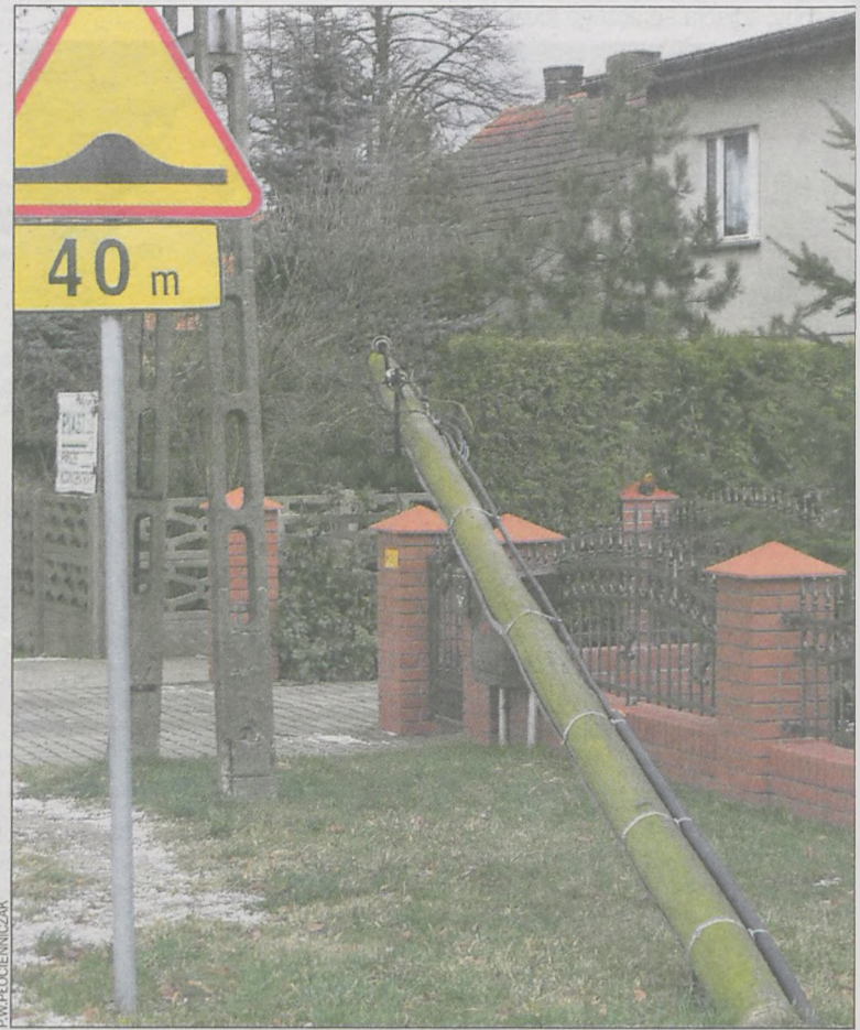
Przewrócony słup na ul. Bolewskiego
