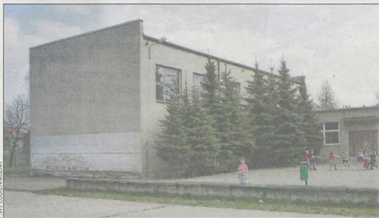
Sala z powodu złego stanu technicznego jest nieczynna już od roku
