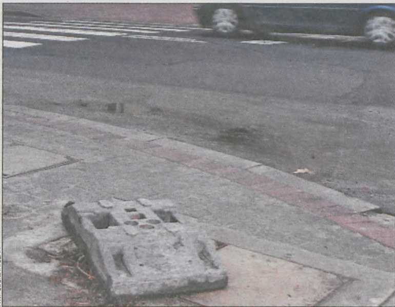
O dziurawą studzienkę i prowizoryczne zabezpieczenie potykają się przechodnie
