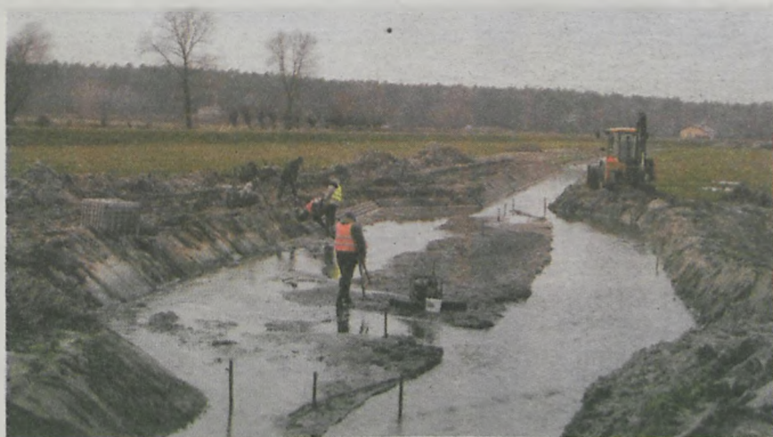
Suchy zbiornik wód deszczowych nr 2 (Osusz)
