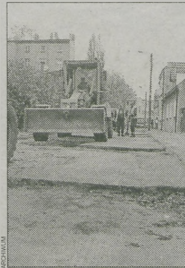
Zamiast wyremontować całą ulicę, pozostawiono kawałki starego asfaltu
