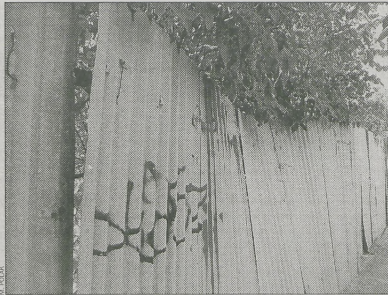
Ogrodzenie rozpada się i chwieje
