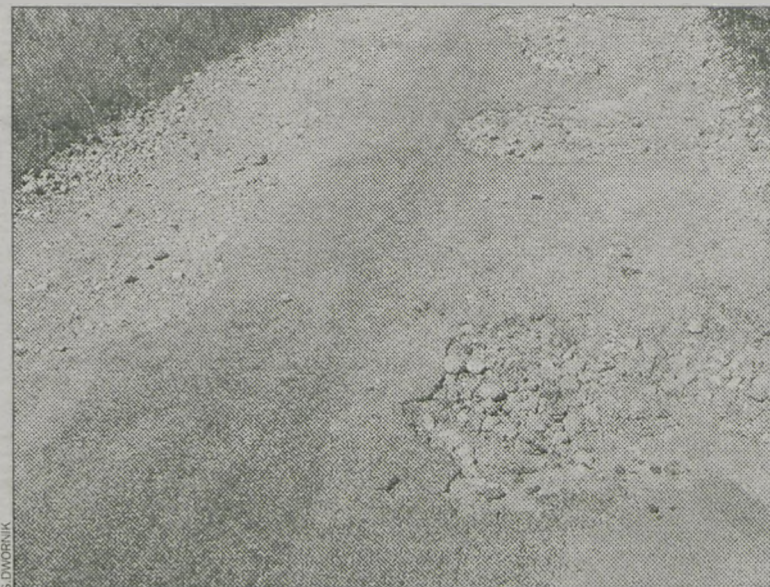
Nawierzchnia jezdni jest niebezpieczna dla pojazdów
