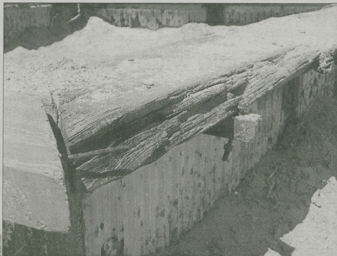
Pordzewiałe ścianki piaskownicy i wystające gwoździe to elementy niektórych spółdzielczych placów
