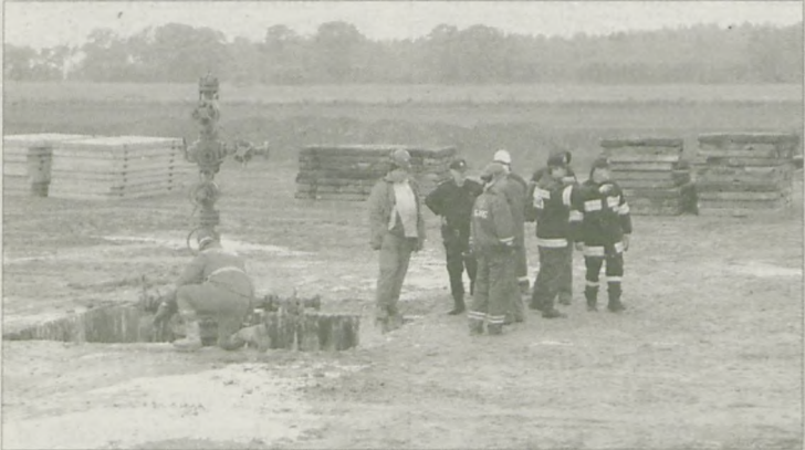
Z POŻAREM GAZOCIĄGU strażacy zmagali się 2 godziny
