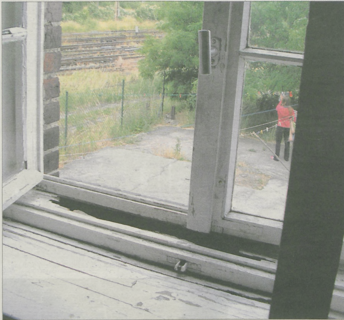
MIESZKAŃCY SKARŻĄ SIĘ, że od panującej w pomieszczeniach wilgoci porobiły się dziury w parapetach
