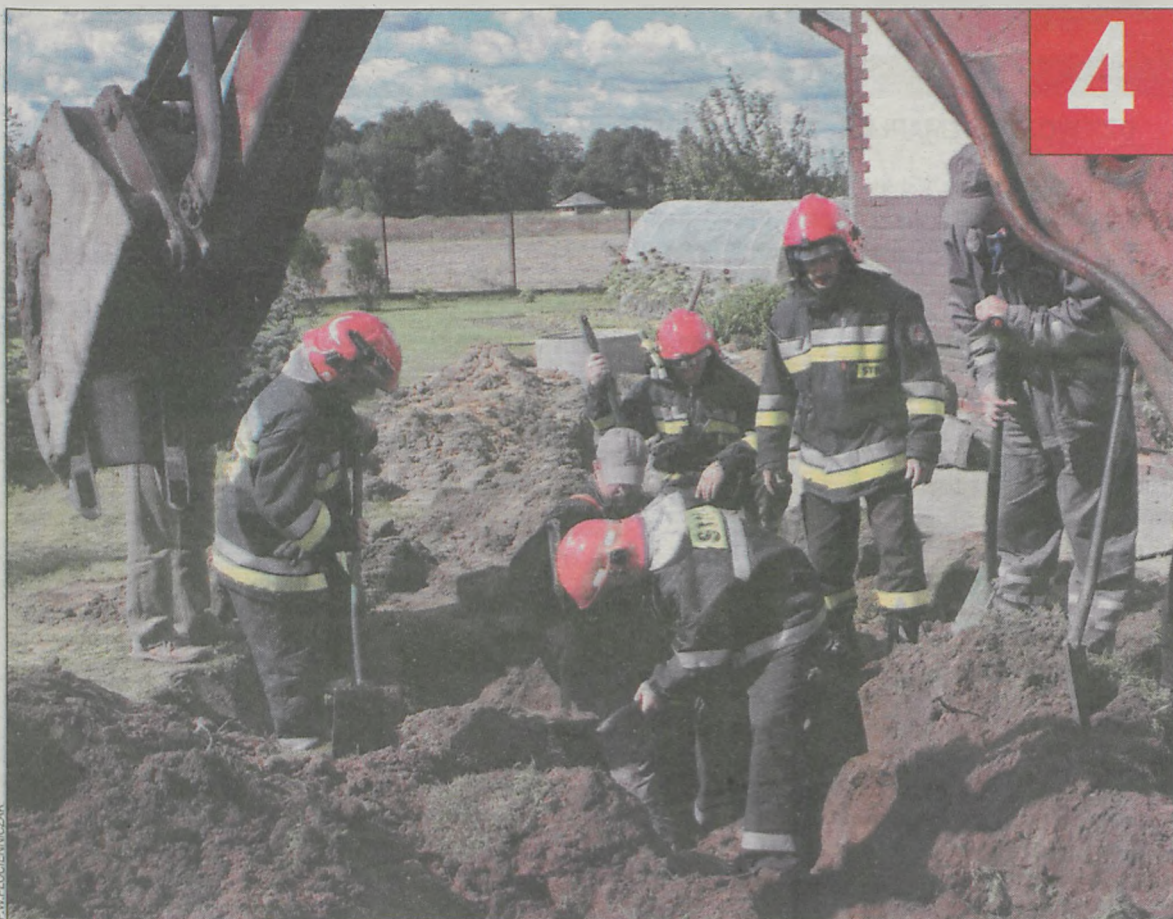
Awarię usunęła straż pożarna i pogotowie gazowe
