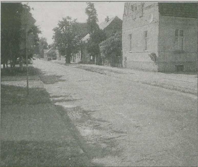
Ulica Rawicka od lat wymaga gruntownego remontu
