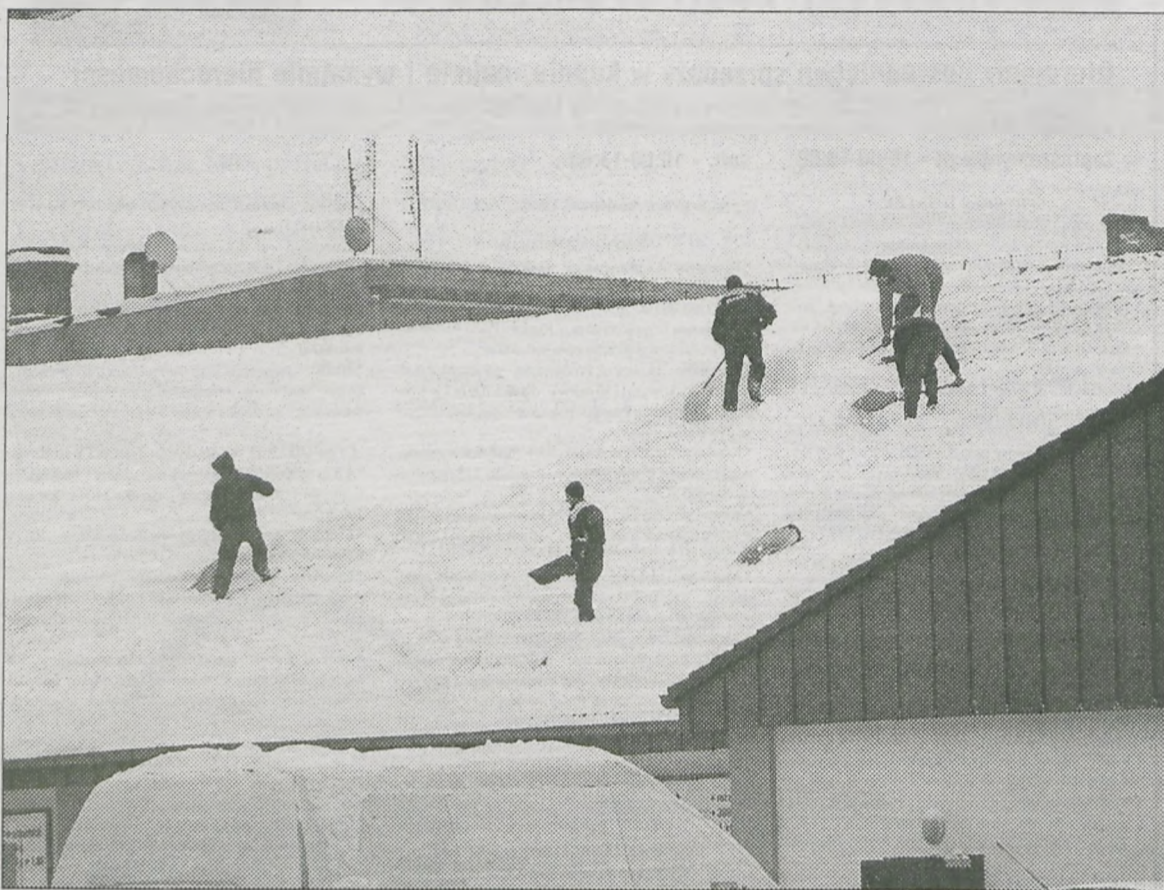
Usunięcie śniegu z dachu Lidla nakazał inspektor nadzoru budowlanego
