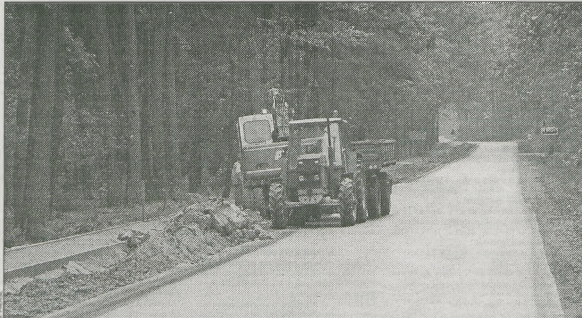
Asfalt został położony we wrześniu. Teraz trwają prace końcowe przy ścieżce rowerowej
