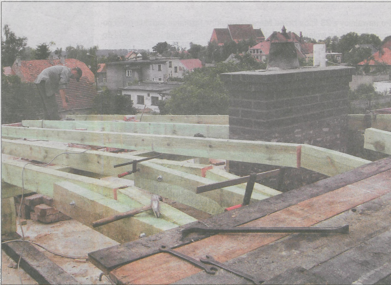
Dach budynku na Langiewicza 5 dni po wicherze
