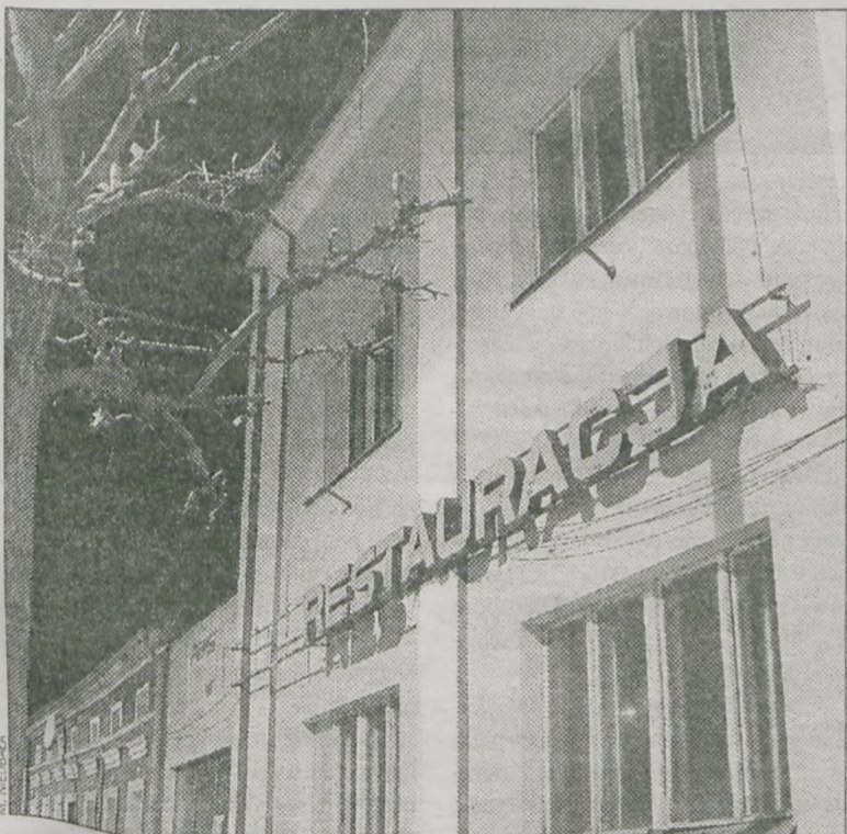
Zaniedbana fasada sugeruje, że obiekt jest opuszczony
