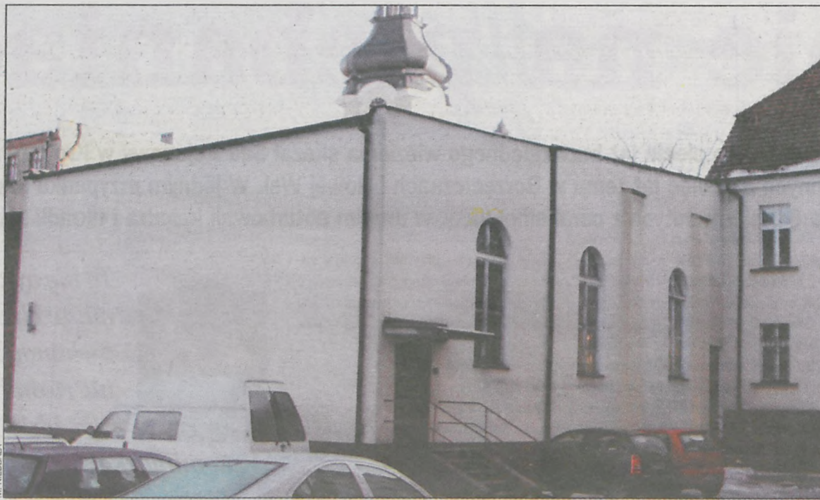
Ta sala nadaje się do gruntownego remontu
