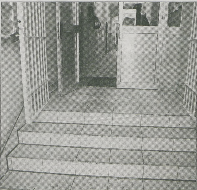
Te schody na razie są ogromną barierą dla niepełnosprawnych
