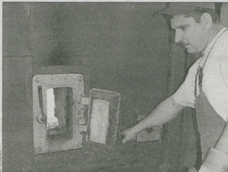
W kotłowni rejonowej ZEC
