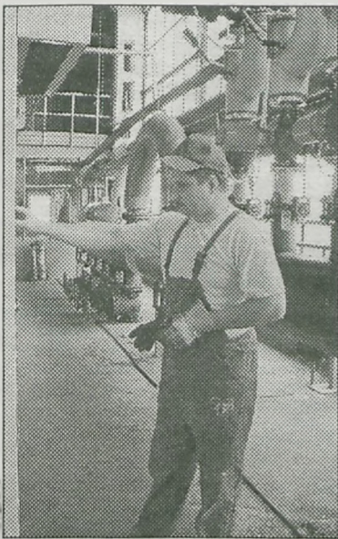
ZEC stara się zmodernizować kotłownię
