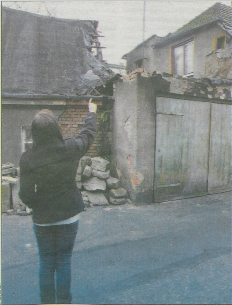
Budynek nie nadaje się do zamieszkania
