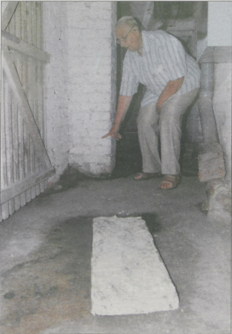
Woda w piwnicy sięgała nawet do wysokości czwartej cegły – pokazuje S. Majchrzak
