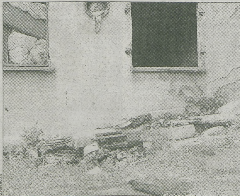
Na zewnątrz budynku ślady pożaru są prawie niewidoczne
