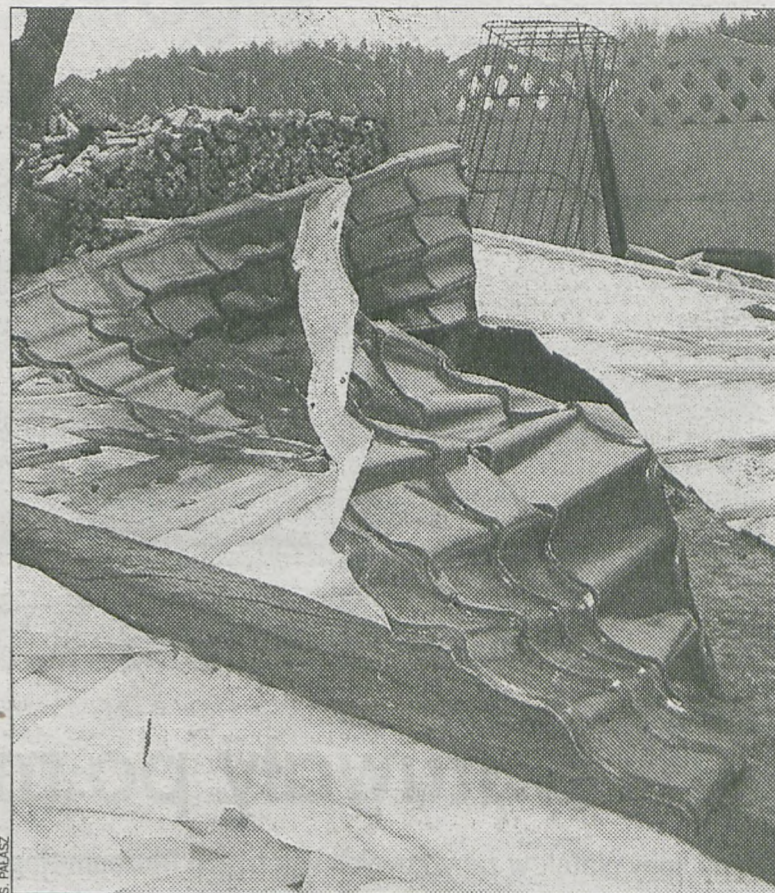
Wiatr zrobił z dachu harmonijkę
