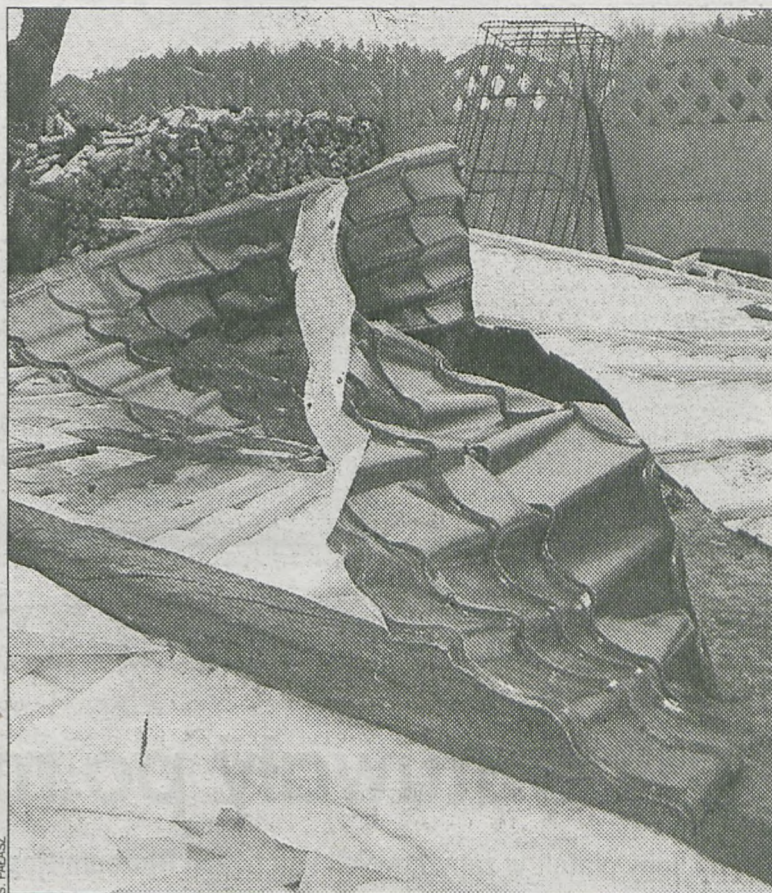
Wiatr zrobił z dachu harmonijkę
