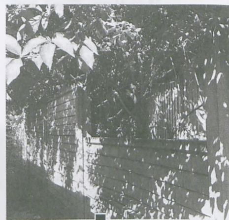
Zniszczony płot parkingu fot. Jan Błaszczak
