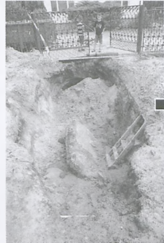
Miejsce zdarzenia nazajutrz. W wykopie widać drabinę i betonową płytę, która obsunęła się na pracujących fot. Piotr P. Ruszkowski
