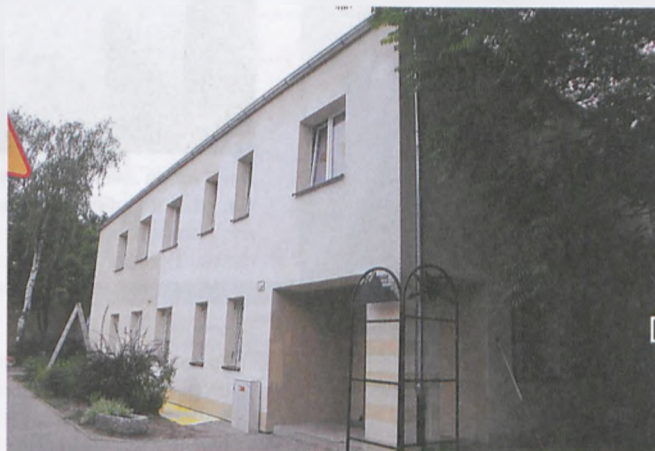
Niedokończona elewacja Biblioteki Miejskiej po termomodernizacji fot. Piotr P. Ruszkowski
