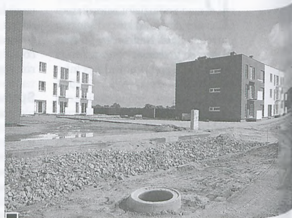
Brak drogi dojazdowej do budynków nr 7 i 8, które już powinny być zasiedlone
