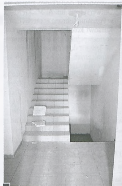
Na klatkę schodową B w budynku nr 7 zamiast granitu płytki gresowe, niezabezpieczone schody, sufity bez lamp, niepomalowane ściany i nikogo na budowie
