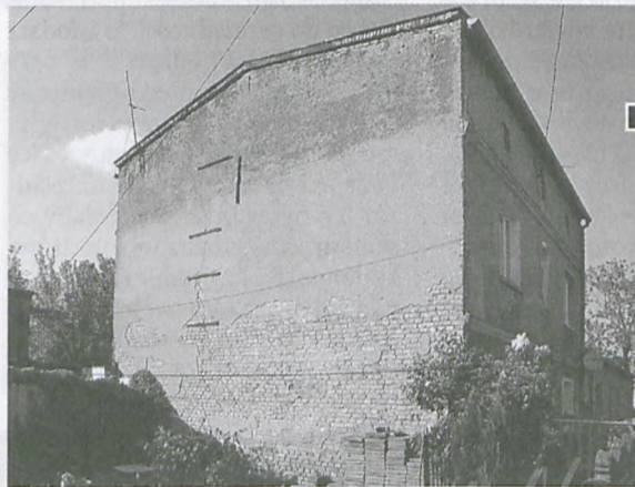
Metalowe klamry na pęknięciach ścian szczytowej założono przed rokiem. Same pęknięcia, zdaniem lokatorów, powstały dużo wcześniej fot. Piotr P. Ruszkowski
