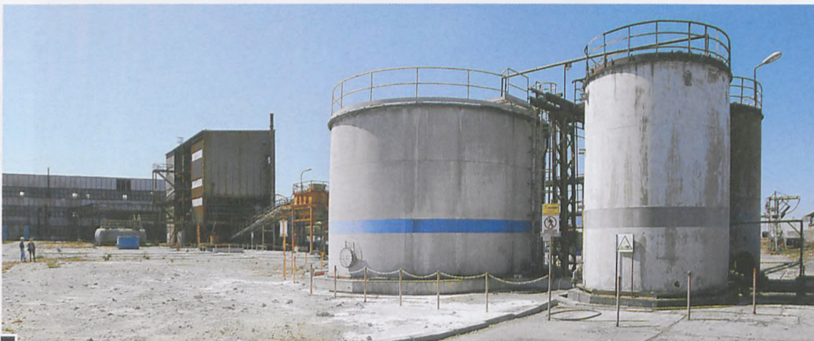
Zbiorniki kwasu H 2 SiF 6 o łącznej pojemności prawie 50 metrów sześciennych stanowiących potencjalne zagrożenie w przypadku ich rozszczelnienia. Uwolnienie zawartej substancji spowodować mogło poważne skażenie środowiska bardzo niebezpieczne dla ludzi w promieniu kilku kilometrów fot. Piotr P. Ruszkowski
