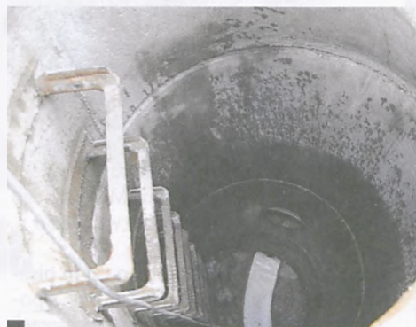
Studzienka kanalizacyjna w ul. 3 Maja. Bezpośrednio pod drabinką znajduje się wlot podłączenia z osiedla Warta Park fot. Piotr P. Ruszkowski
