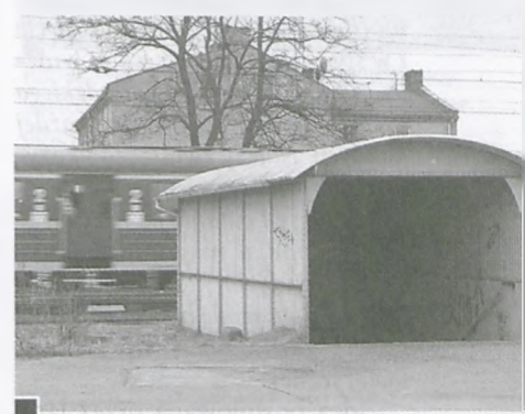
Zaniedbane przejście podziemne z ul. Dworcowej do ul. Armii Poznań na wysokości ul. Fabrycznej
