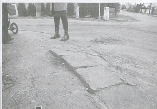
Chodnik na skrzyżowaniu ul. Szkolnej i Długiej w wtłoczonym w grunt krawężnikiem i niebezpiecznie wypchniętymi płytami fot. Piotr P. Ruszkowski
