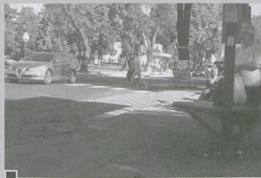
Nierówny chodnik na przystanku przy ul. Poniatowskiego powoduje, że traci się równowagę fot. Ada Kołazińska
