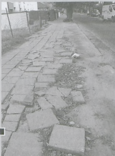
Rozjeżdżone ciężkimi pojazdami płytki chodnika na ul. Kołtątaja fot. Hanna Siatka
