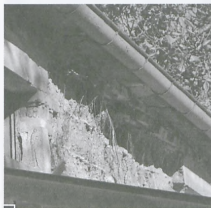
Mur z pustaków rozsadzany przez korzenie brzoź rosnących na dachu fot. Piotr P. Ruszkowski
