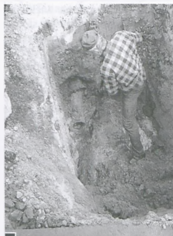
Ujawniona fuzzera – prowizoryczna naprawa popękanej rury betonowej luźnym wkładem z rury plastikowej. fot. Piotr P. Ruszkowski
