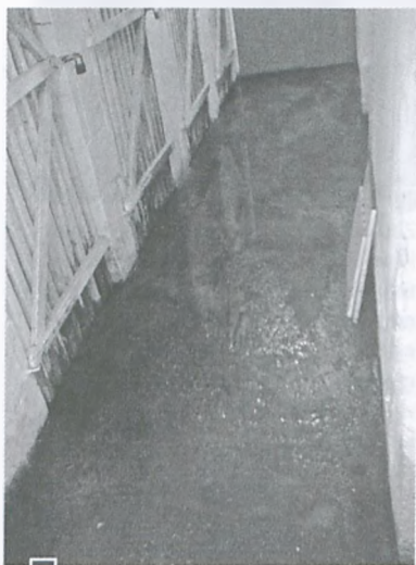
Piwnica bloku przy ul. Kościuszki 55 zalana fekaliami fot. Katarzyna Polerowicz-Kelma
