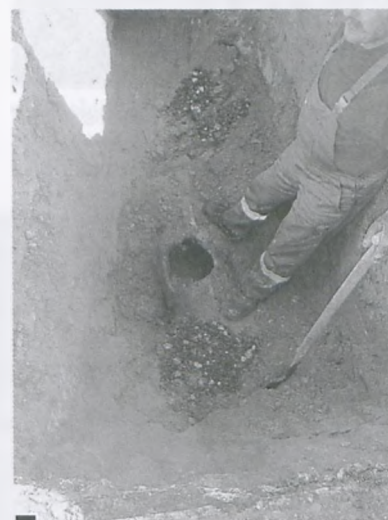
Pozostawione bez należytego zabezpieczenia stare podłączenie posesji do kanalizacji deszczowej na ul. Niepodległości. fot. Kom-Lub
