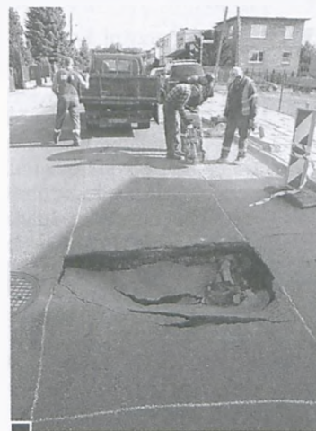
Zapadnięcie asfaltu na ul. Ignacego Krasickiego (ok. 50 m za Komisariatem Policji). Aż strach pomyśleć, co mogłoby się stać, gdyby w głęboką na pół metra dziurę wielkości ok. 2x1 metra wpadł samochód nawet z niewielką prędkością. fot. Piotr P. Ruszkowski
