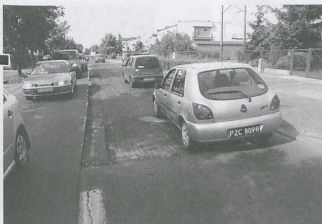
Ul. Żabikowska w kierunku Łęczycy. Jak nas poinformowano, ten znaczny i występujący na dużej powierzchni ubytek w jezdni, w nocy z 21 na 22 czerwca nie był w ogóle oznakowany. fot. Hanna Siatka
