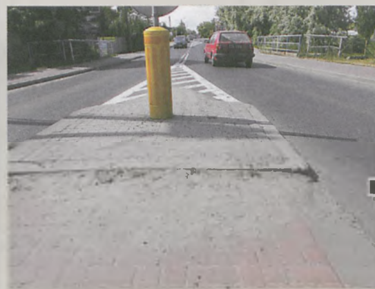
Wysepka przejścia dla pieszych przy rondzie zasypała pozimowym piaskiem... fot. Piotr Paweł Ruszkowski
