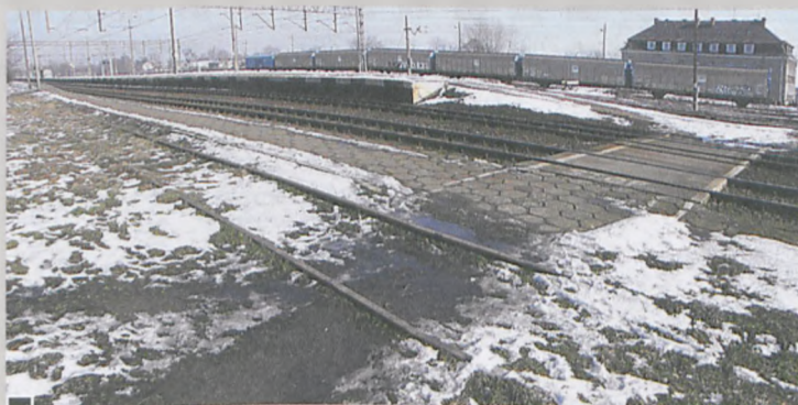
Przeszkodą dla wielu niepełnosprawnych w dotarciu na perony są wystające tory na nieczynnej a niezdemontowanej do końca bocznicy oraz błoto fot. Piotr Paweł Ruszkowski
