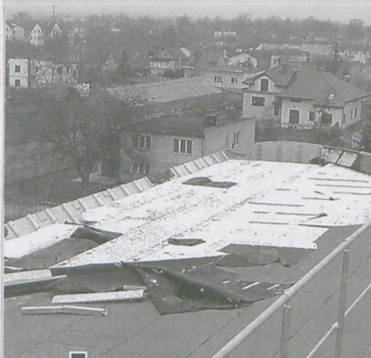
Wichura na początku 2007 r. ujawniła karygodne zaniedbania przy wykonaniu hali widowiskowo-sportowej przy ul. Kołtątaja fot. Leszek Michalik
