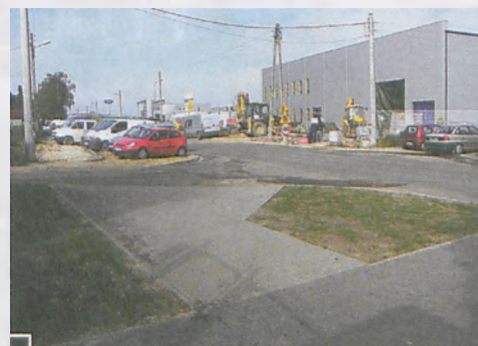
Bezsensownie wyłożony kostką pozbrukową szeroki fragment chodnika wychodzący wprost na skrzyżowanie fot. Hanna Siatka
