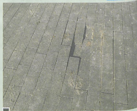
Zapadnięty pozbruk na budowanej ścieżce turystyczno-rowerowej wzdłuż Kocich Dołów fot. Paweł Jankowiak
