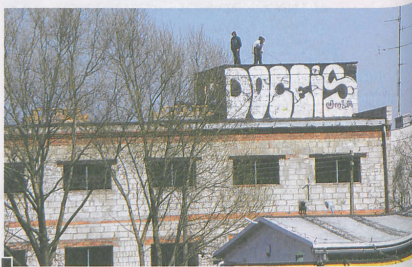
Opuszczony budynek Intersmaku przy ul. Zielonej zaczyna być miejscem spotkań młodzieży. Jedną z ulubionych „zabaw” jest chodzenie po dachu niezabezpieczonego obiektu fot. Hanna Siatka
