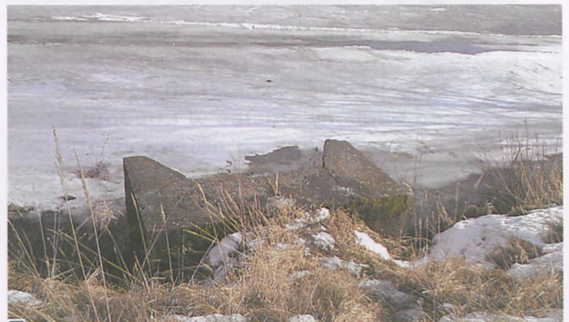
Betonowy wylot kolektora do skutej lodem Warty, zdjęcie z 25 lutego
