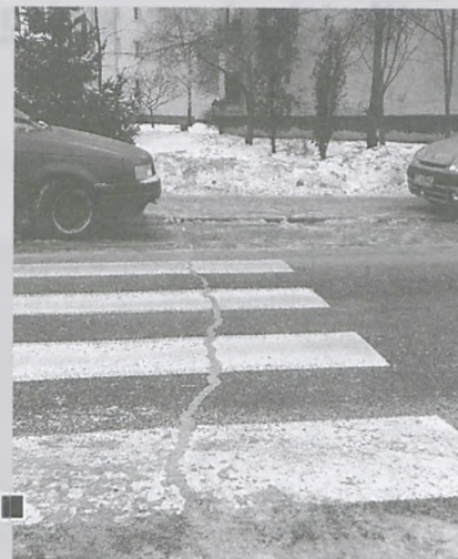
Spękane przejście przez ul. Sikorskiego
