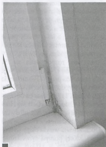
Wilgoć przy futrynie okna – taki widok można spotkać w wielu mieszkaniach obu budynków fot. Hanna Siatka
