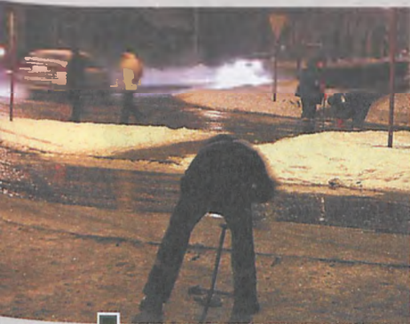
Pierwsze na miejscu zjawili się służby Aquanetu, które z trudem, w mrozie docierały do zaworów wodociągu. Po awarii wezwani przez Straż Miejską pracownicy Kom-Lubu zadbał o zabezpieczenie nawierzchni fot. Piotr P. Ruszkowski
