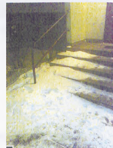
Zasypane schody wejścia do bloku
