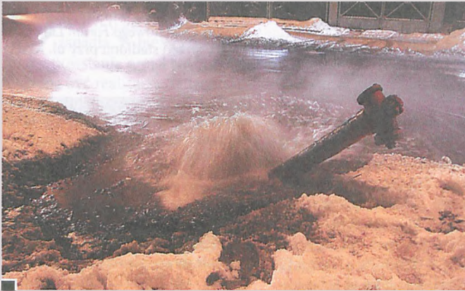
Wyłamany hydrant i wytryskująca na jezdnię woda, która w zetknięciu z zimnym powietrzem tworzyła mgłę fot. Piotr P. Ruszkowski
