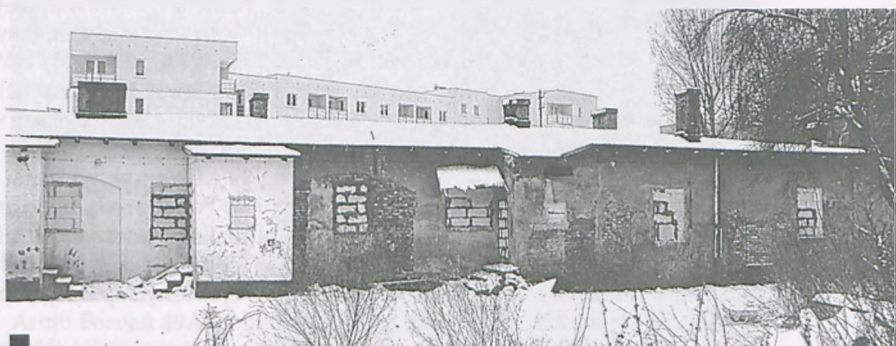
Po publikacji na łamach „WL” w listopadzie ub. roku, 31 grudnia ponownie zamurowano cegłą zdewastowane wcześniej otwory drzwiowe i okienne budynku komunalnego przy ul. Kościuszki 39. JB
