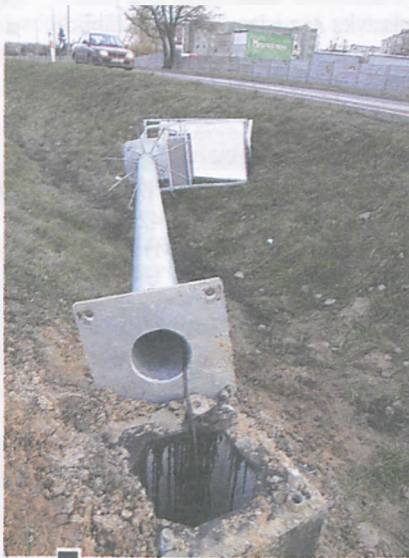
To samo miejsce od strony podstawy słupa w dzień po dewastacji fot. Piotr P. Ruszkowski
