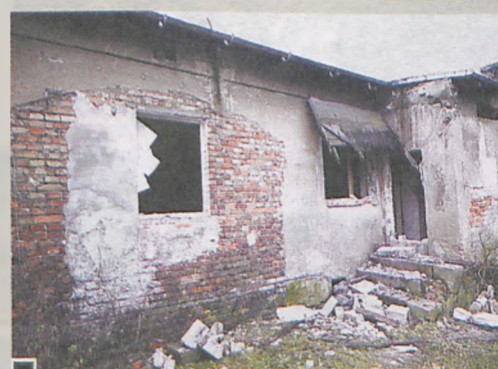
Wypchnięte zamurowane otwory okienne i drzwiowe w zniszczonym budynku komunalnym przy ul. Kościuszki 39 fot. Paweł Jankowiak
