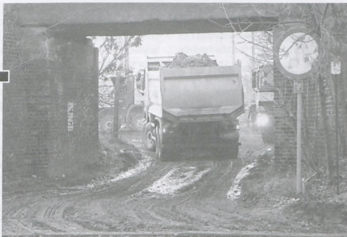
Niebezpieczne i zabłocone przejście dla pieszych pod tunelem kolejowym przy ul. Armii Poznań na wysokości ul. Podgórnej
