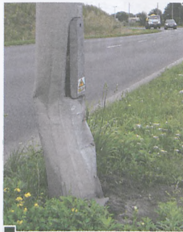
Poważnie uszkodzona podstawa drugiej latarni fot. Hanna Siatka
