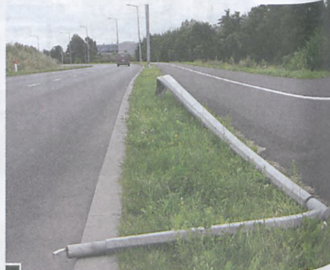
Przewrócony słup oświetleniowy na ul. Unijnej, a za nim drugi – poważnie uszkodzony przy podstawie fot. Hanna Siatka
