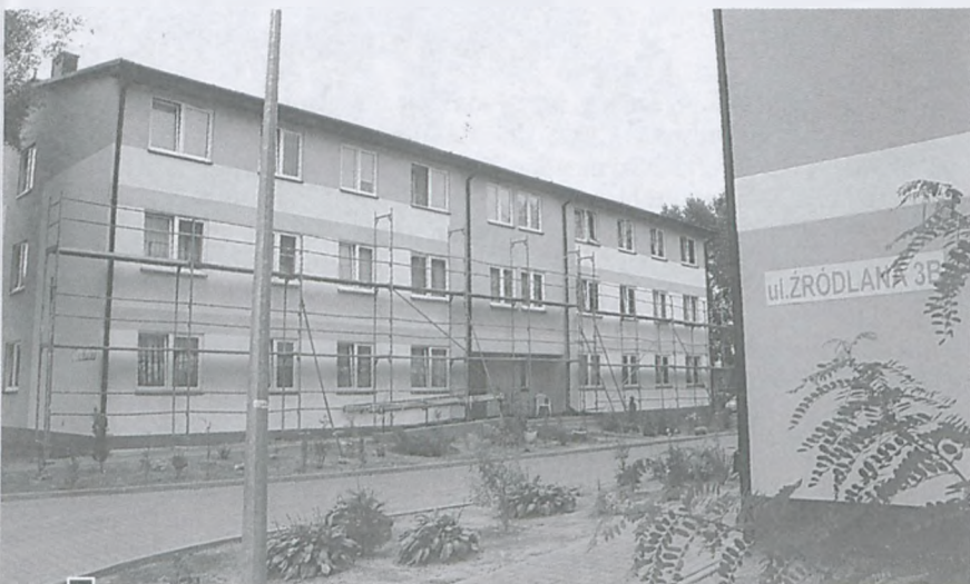
Prace naprawcze w ramach reklamacji na budynkach przy ul. Źródlanej fot. Hanna Siatka
