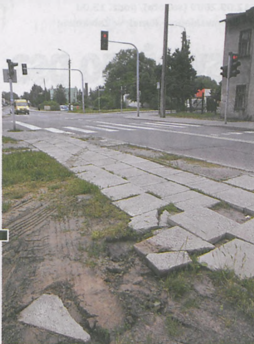
Zdewastowany chodnik przy Powstańców Wlkp. ze świeżymi śladami przejazdu, w głębi skrzyżowanie z ul. Puszkina i ks. Streicha fot. Piotr P. Ruszkowski
