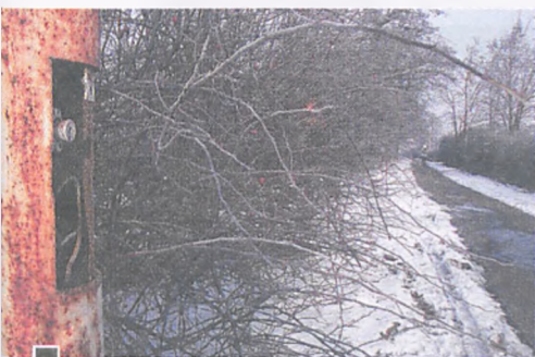
Niebezpieczna, pozbawiona osłony latarnia – dostępna dla przechodniów fot. Piotr P. Ruszkowski
