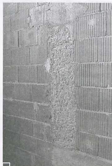
Przykład konieczności poprawiania jakości pracy poprzedniego wykonawcy w hali widowiskowo-sportowej przy ul. Kółkątaja. W wielu miejscach należało skuwać wystające nadlewki betonowe fot. Piotr P. Ruszkowski
