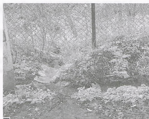
Ciemny ślad wzdłuż ogrodzenia zlewni po lewej stronie obiektu i betonowy przepust pod płotem wskazujący na pozbywanie się ścieków z samochodów asenizacyjnych za teren wylewiska, w kierunku znajdującego się tam zbiornika wodnego fot. Hanna Siatka
