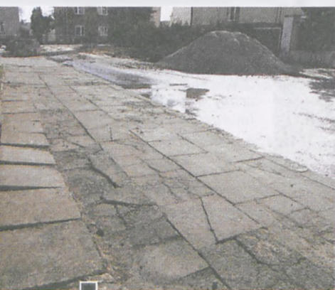
Chodnik na ul. Jagiełły zrujnowany przez sprzęt budujący ulicę Konopnicką fot. Piotr P. Ruszkowski
