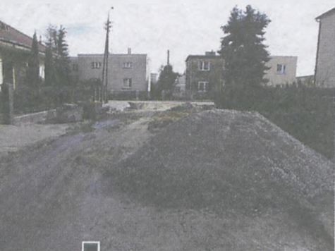
Hałdy zmagazynowanego do budowy drogi materiału na ul. Jagiełły zawalają chodnik i guliki fot. Piotr P. Ruszkowski
