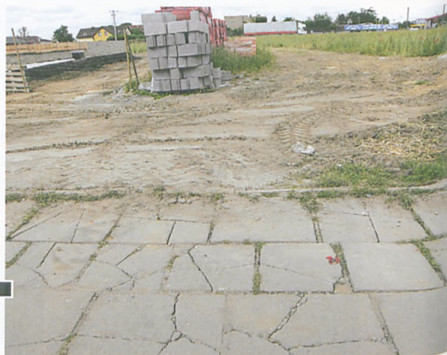
Zniszczone płytki chodnikowe na ul. Jana Panka fot. Magdalena Woźniak-Patej
