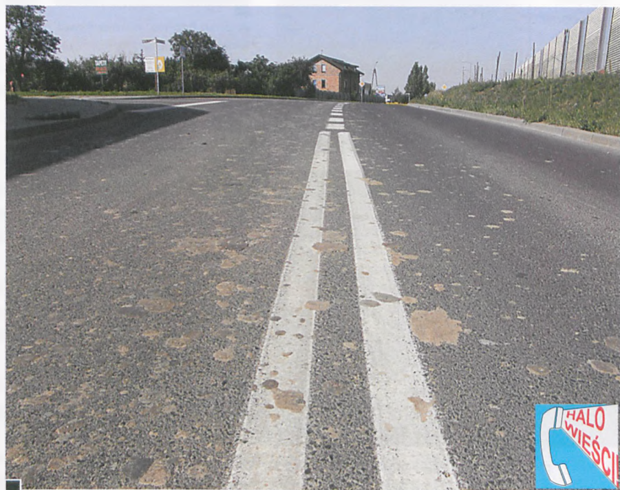
Grudy ziemi i gliny wjeżdżone w asfalt fot. Piotr P. Ruskowski
