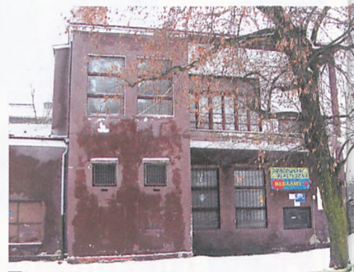
Z przemrożonych ścian odpada tynk i farba fot. Paweł Jankowiak
