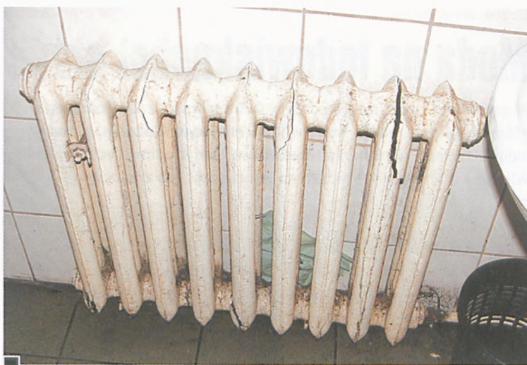
Przejmującego mrozu w budynku nie wytrzymały nawet żeliwne kaloryfery, które popękały. Na sfotografowanym grzejniku widać aż siedem pęknięć. fot. Paweł Jankowiak
