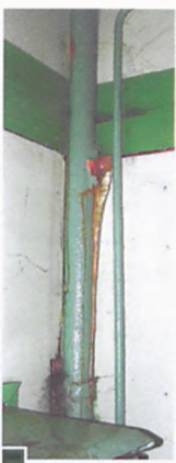
Pęknięta i oblodzona rura kanalizacyjna fot. Paweł Jankowiak
