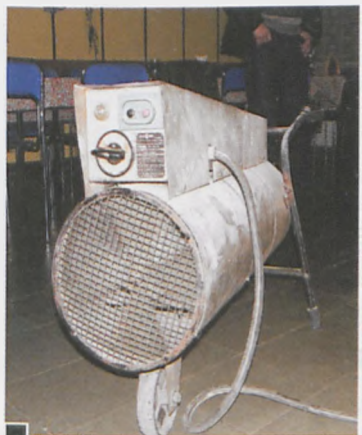
Obecnie do ogrzewania gmachu służą doraźnie dwie nagrzewnice elektryczne. fot. Paweł Jankowiak
