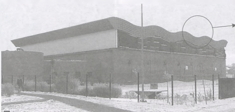
Falistość dachu hali widowiskowo-sportowej przy Gimnazjum nr 2 sprzyja zaleganiu śniegu i lodu w zagłębieniach konstrukcji, co widać na zbliżeniu (stan budowy na początku lutego) fot. Paweł Jankowski
