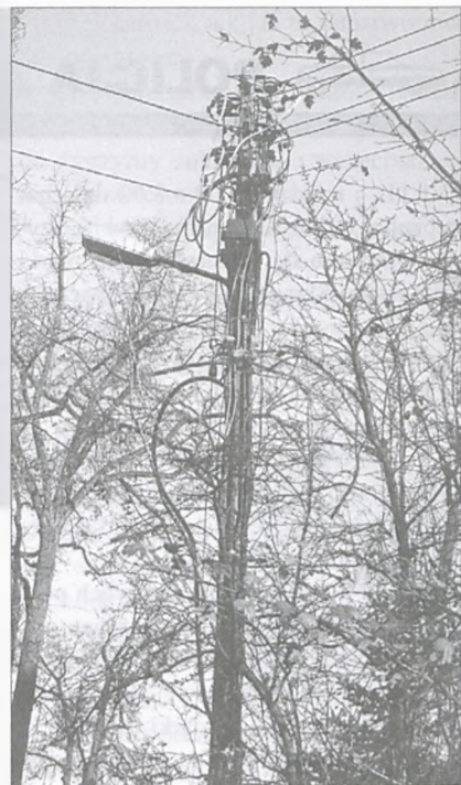
Platanina przewodów na starym słupie przy ul. Poniatowskiego
