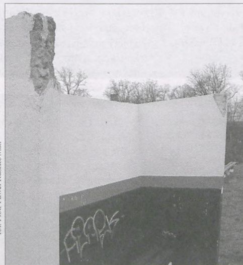
Wiata, z której zerwano zadaszenie
