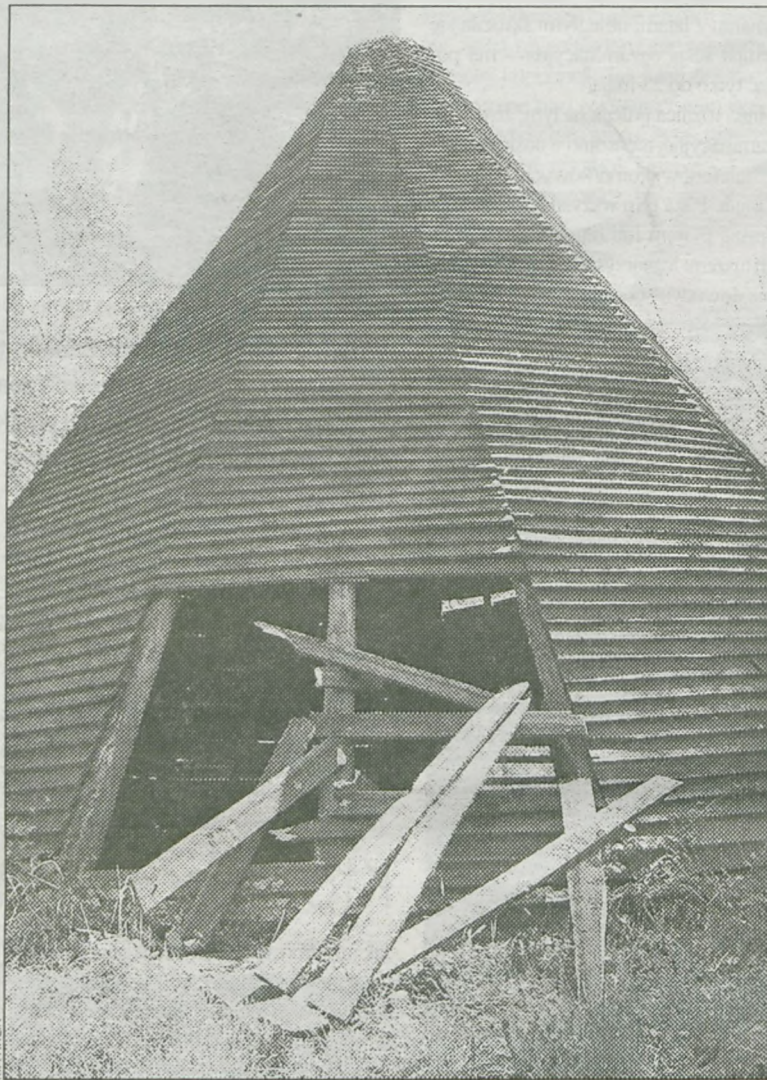
Wandale powyrwali deski
