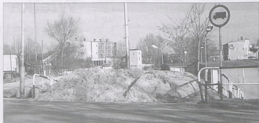
By udrożnić wjazd do garaży niedawno w tym miejscu specjalnie zlikwidowano rurę ciepłowniczą
