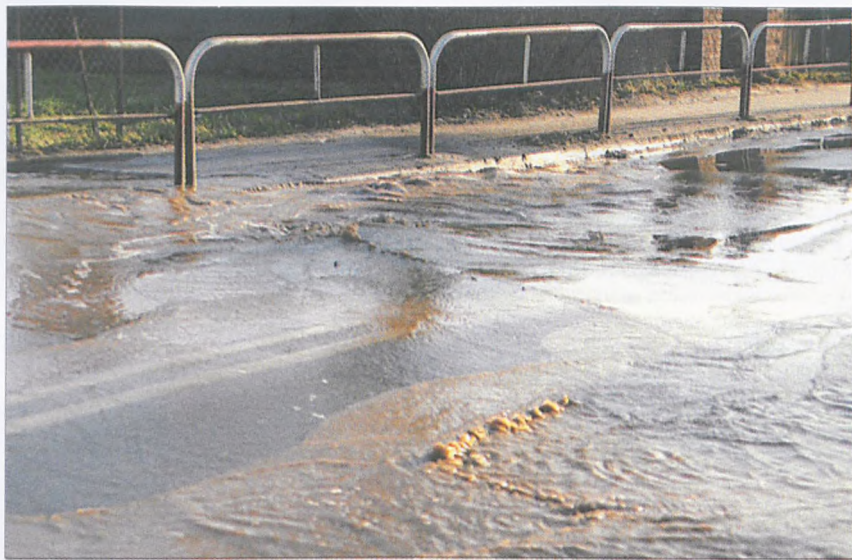
Przez wypchnięty i splekany asfalt woda wydostaje się spod powierzchni zbierając ze sobą piasek z podłoża jezdni
