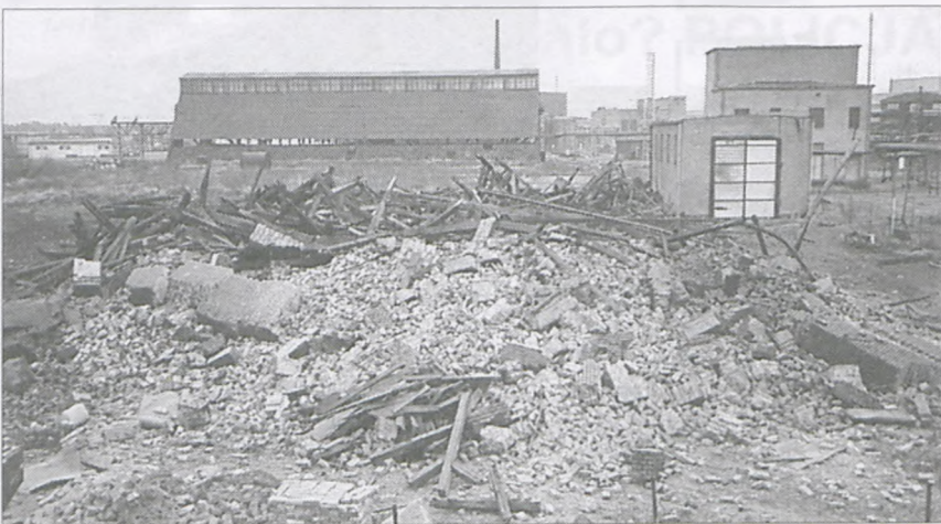
Szczątki konstrukcji i gruz po zburzeniu budowli
