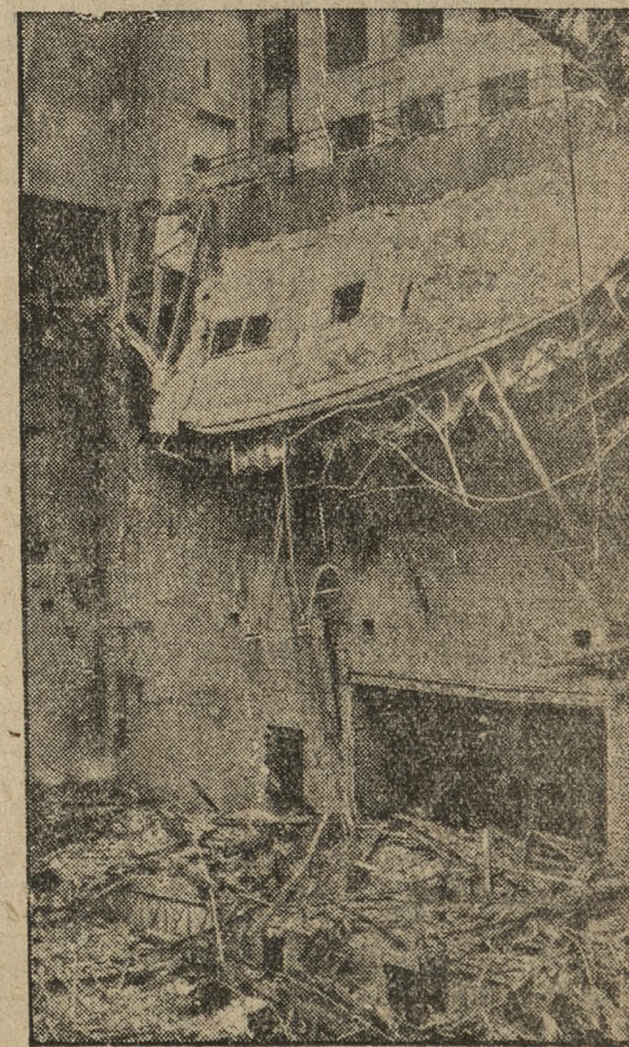
Widok sali posiedzeń plenarnych całkowicie zniszczonej przez pożar.
